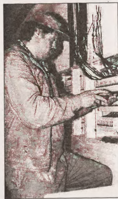
W środku trwają już ostatnie prace wykończeniowe. Po 20 stycznia rozpocznie się proces przekazywania budynku inwestorowi. Elektromonter Zbigniew Szymanowicz spieszy się, aby na czas podłączyć kable w tablicy rozdzielczej
