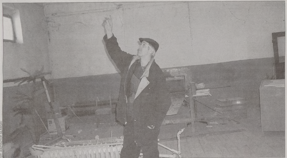
Sołtys prezentuje salę wiejską. Potrzeba dużego remontu i dużych pieniędzy
