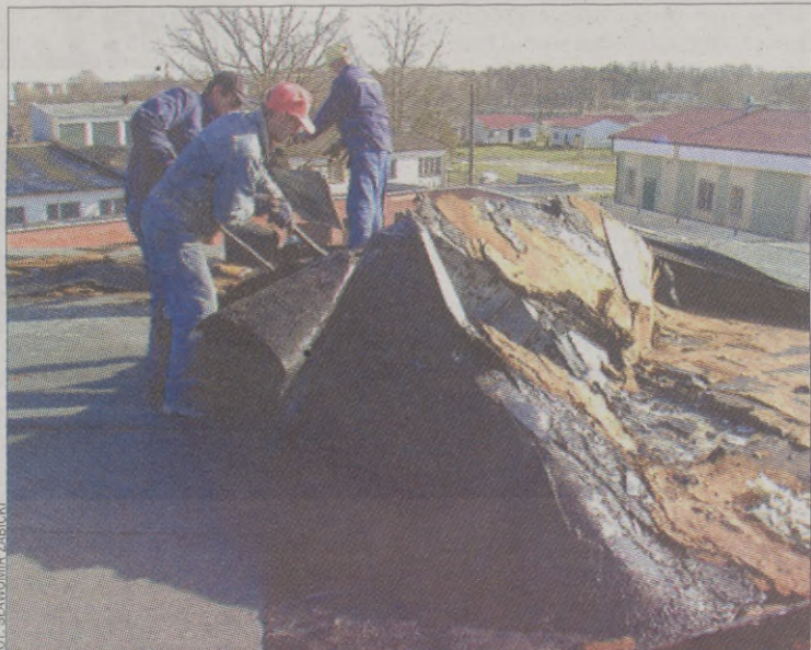
Solidny, blaszany dach trąba powietrzna rozerwała jak puszkę po piwie. Jego elementy znaleziono na boisku szkolnym kilkaset metrów od budynku
