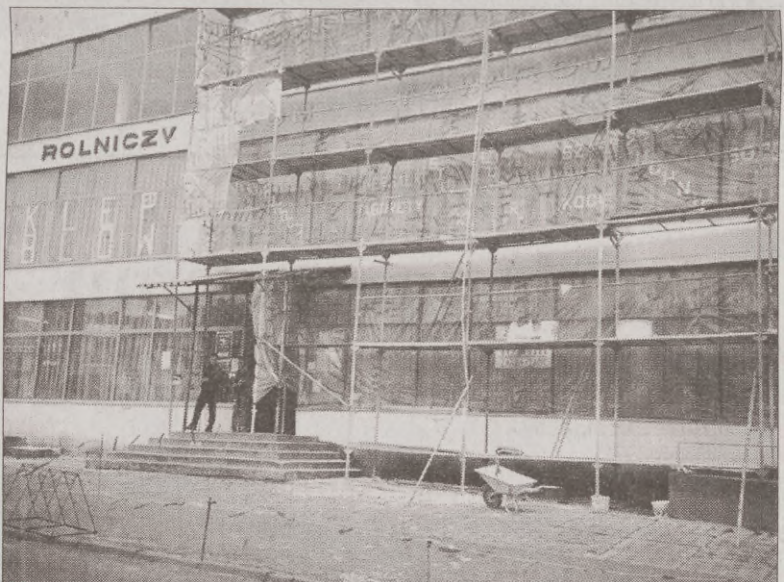
GŁÓWCZYCE. Rolniczy Dom Towarowy przez wiele lat straszyl swoim wyglądem, a odpadający tynk zagrażał przechodniom. W rękach nowych właścicieli staje się potrzebnym i zadbanym obiektem. Nie będzie już szpecił centrum wsi. (basia)
