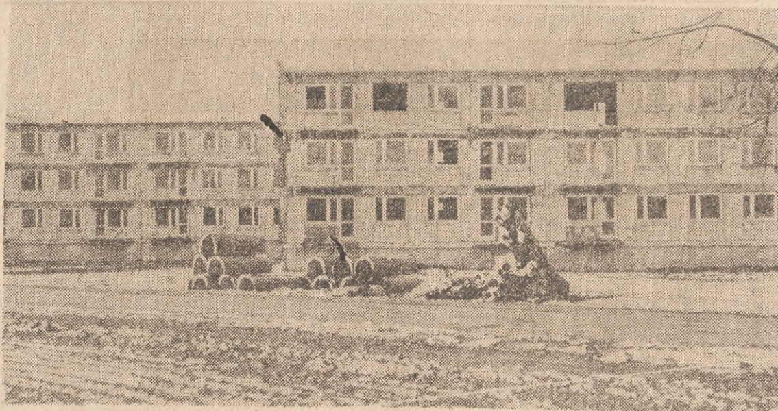
Ludzie w wielu miejscowościach nie mają gdzie mieszkać, a te dwa domy, zbudowane pod potrzeby fermy drobiowej w Wiklinie niszczeją. Ażby się ktoś do nich wprowadził, zamurowano wejścia na klatki schodowe.
