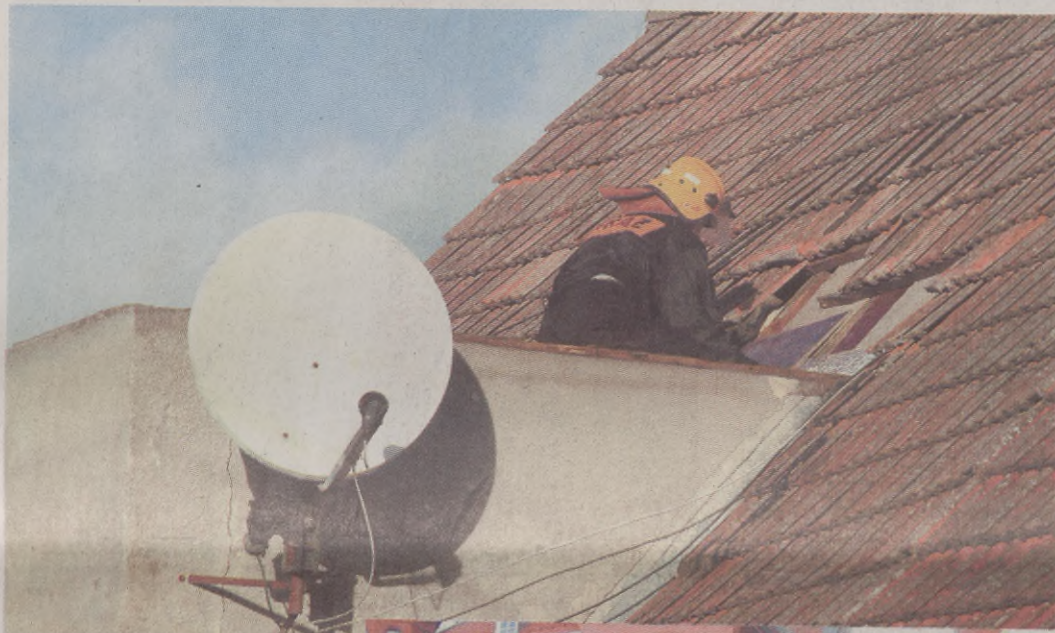
Fot. SŁAWOMIR ŻABICKI Wiatr zerwał część dachu na budynku w Łosinie...
