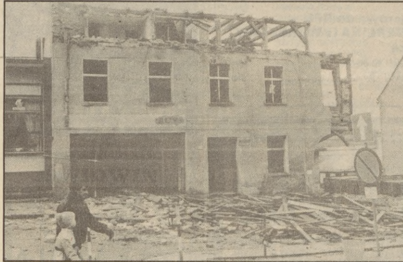
Przy ulicy Królowej Jadwigi w Miastku kilkanaście dni temu widoczny na zdjęciu budynek zawałił się, nie powodując na szczęście żadnych szkód. (ang)
