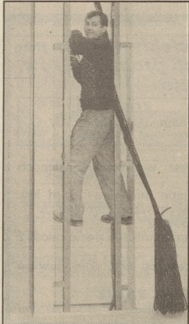
W budynku przyszłego Wojewódzkiego Centrum Telekomunikacyjnego w Słupsku zakończono montaż drabinek kablowych do połączeń światłowodowych. Fot. BARTOSZ ARSZYŃSKI
