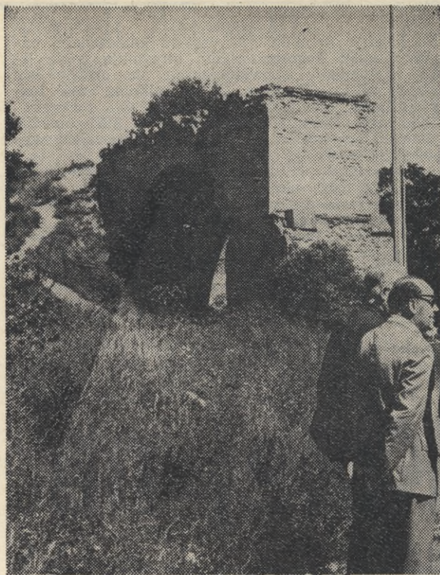
Takie masywne są przyczółki uszkodzonych wiaduktów kolei kokoszczańskiej. Przyczółek wiaduktu nad ul. Wita Stwosza
