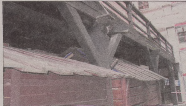
Zamkowy balkon jest przeznaczony w części do wymiany.
