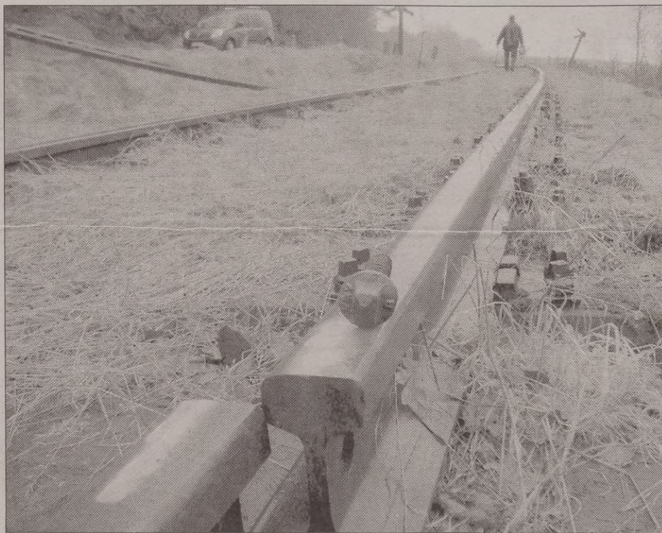
Tory koło Gumieńca. Na zdjęciu widać niedokończoną pracę złodziei złomu.
