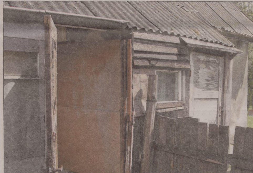
W tym roku jest okazja na pozbycie się dachu azbestowego.
