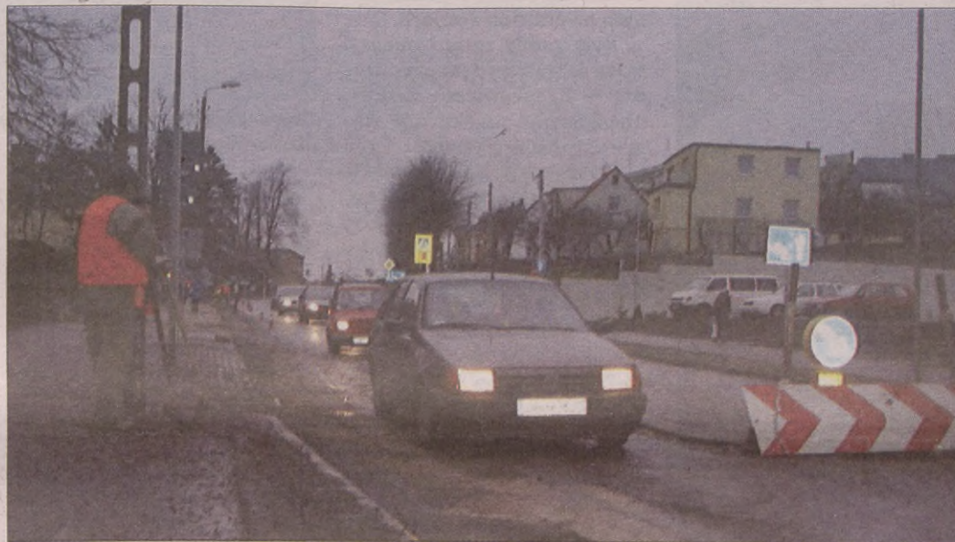
Drogowcy po przebudowie ulicy Sikorskiego zostawili olbrzymie wyrwy.
