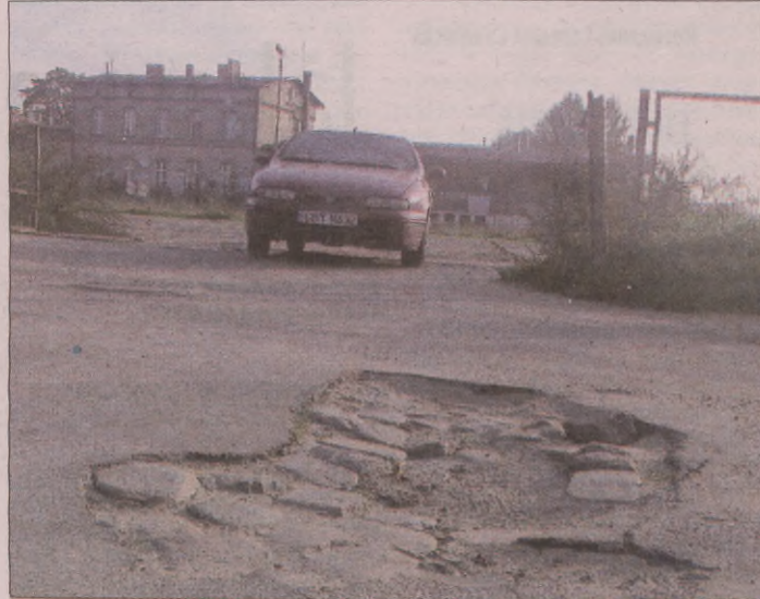
Dziura na skrzyżowaniu ulic Kolejowej i Pałuckiej w Miastku zostanie załatwana, ale to nie rozwiąże problemu.
