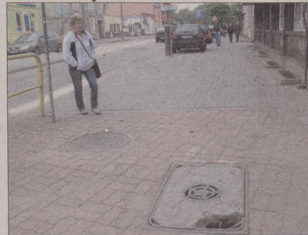
Dziurawa pokrywa studzienki na chodniku przy ulicy Koszalińskiej w Miastku.
