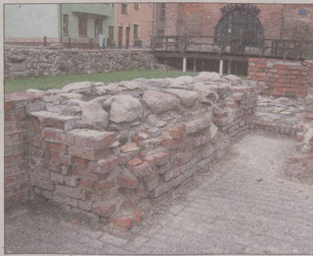
Mury na Placu Świątej Katarzyny w Bytowie od lat się sypią.
