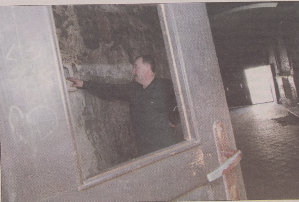
Zrujnowana brama w kamienicy przy ul. Kilińskiego 46.
