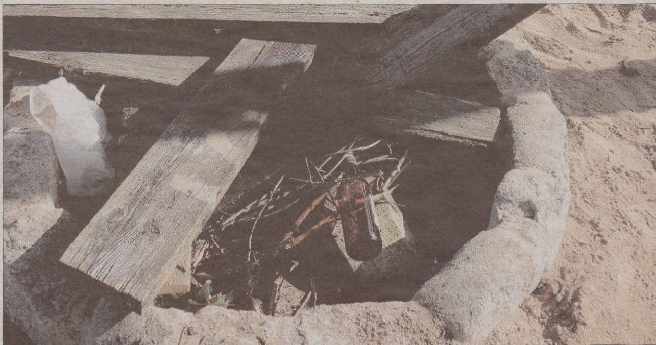
Mimo że miejsce rekreacyjne nie zostało jeszcze formalnie odebrane, wandale już zaczęli je niszczyć.
