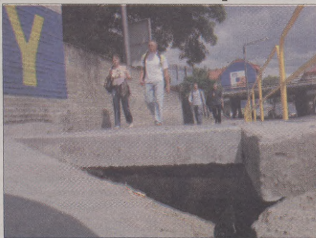
Dziura w chodniku przy ul. Szczecińskiej.
