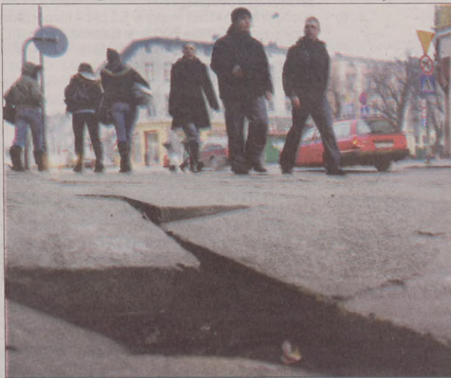
Dziura na chodniku przy ul. Mickiewicza.
