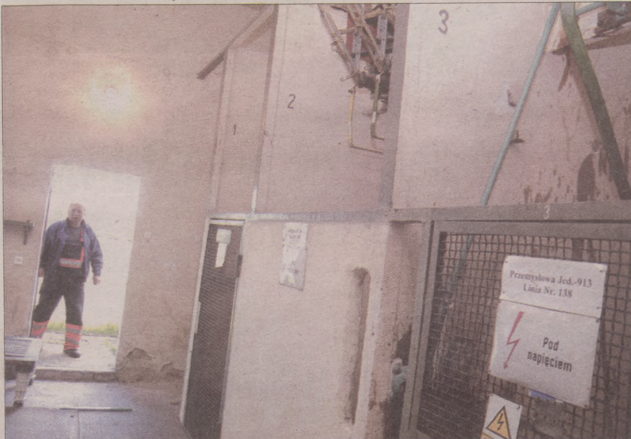
Stacja transformatorowa przy ul. Krzywoustego. Była otwarta i niezabezpieczona co najmniej kilka dni.
