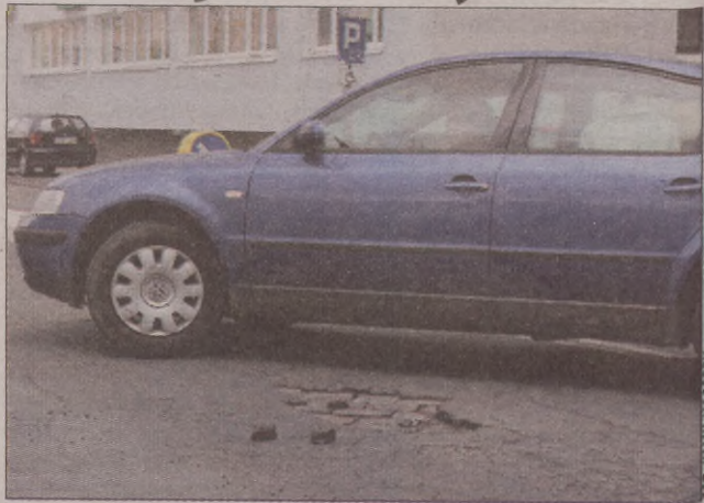
Dziurawa nawierzchnia przy ul. Grodzkiej.
