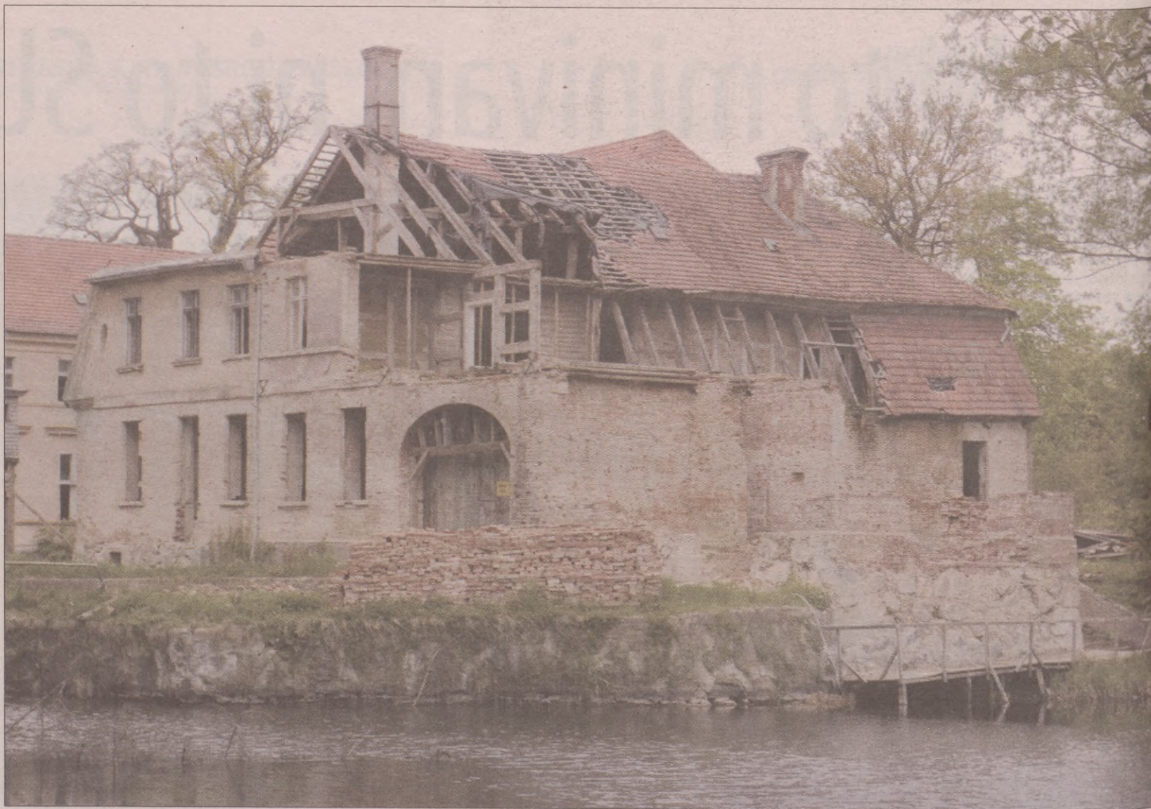
Zniszczony pałac w Karzniczce.
