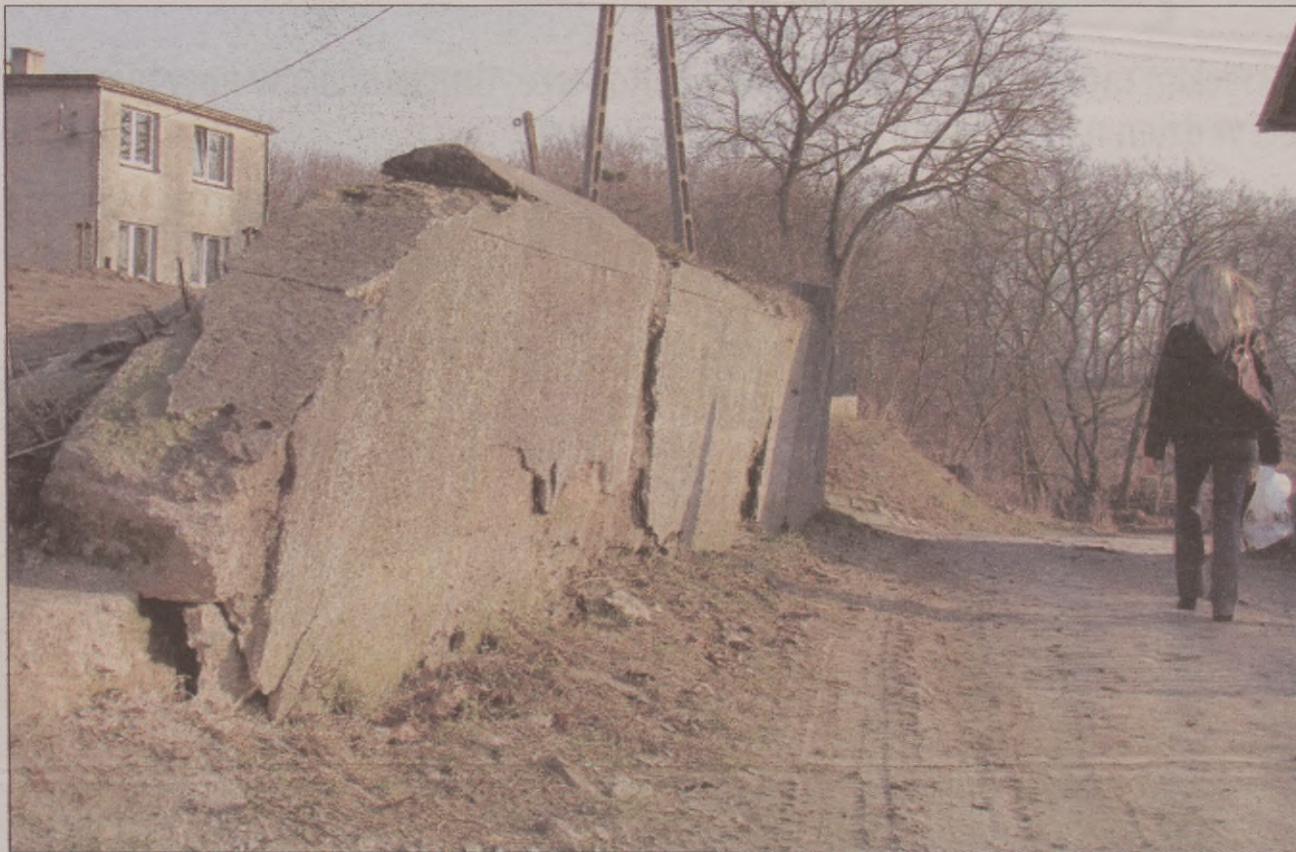
Popękany mur powinien zostać naprawiony – twierdzą mieszkańcy.
