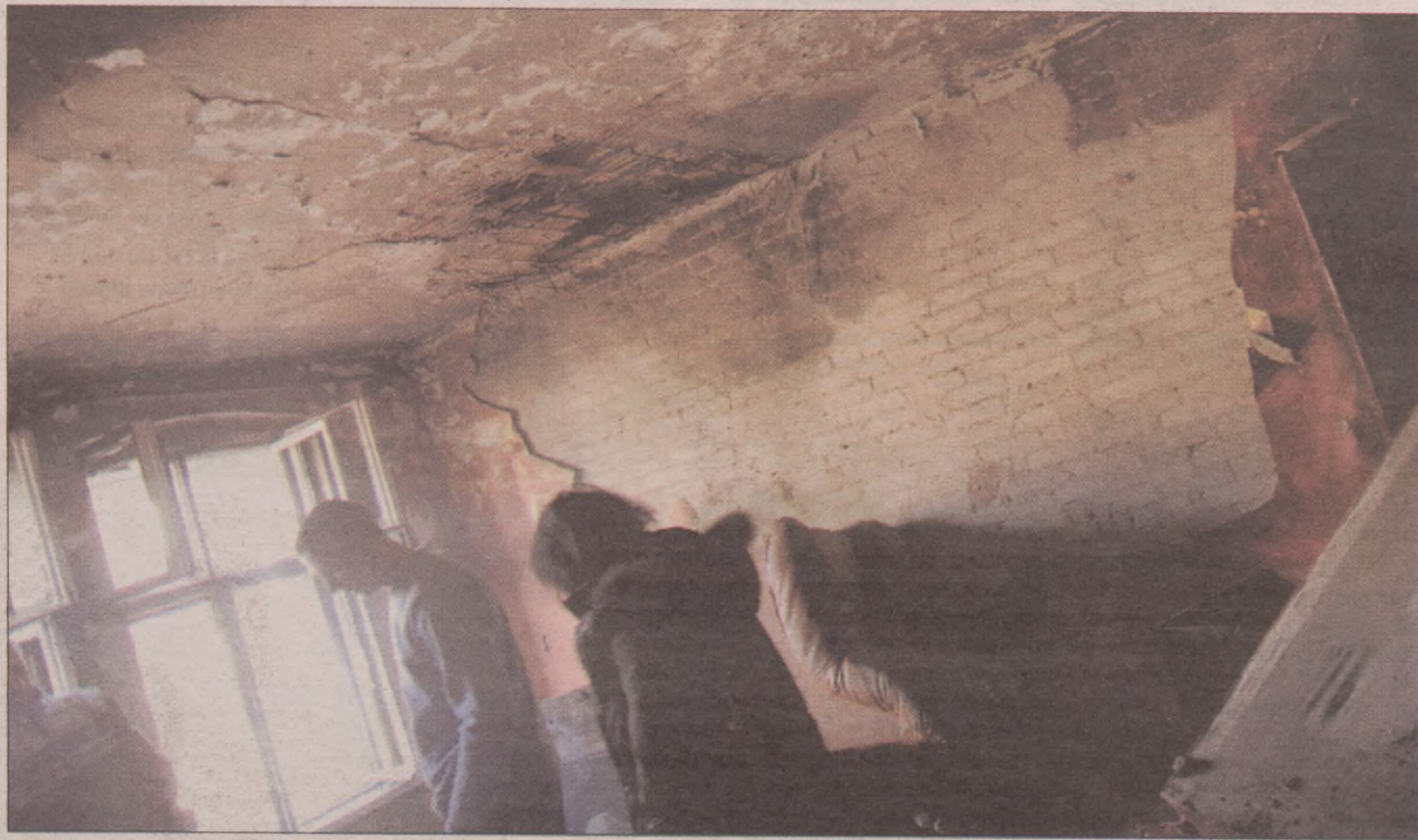
Mieszkanie na drugim piętrze kamienicy przy ul. Małachowskiego spłonęło doszczętnie.
