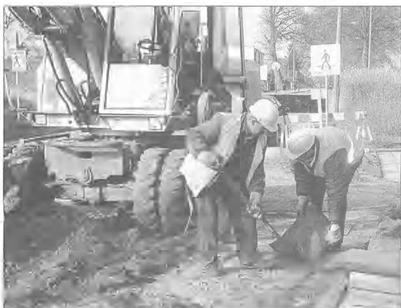
Firma „Eko-Instal” ze Studzienic zakończyła prace przy budowie kanalizacji sanitarnej na ulicy Kolejowej w Miastku. Teraz sieć ukladana jest wzdłuż ulicy Kaszubskiej, a także w pobliskiej Wolczy Wielkiej. Inwestycja zakończona zostanie w listopadzie tego roku. (ang)
