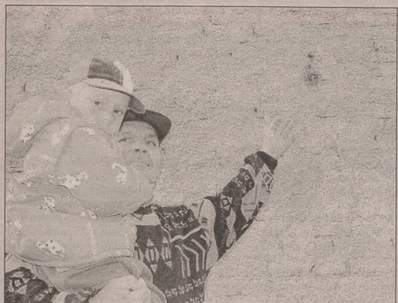
Pan Aleksander z wnukiem Pawłem wskazuje dziury w ścianie budynku, którymi do wewnątrz dostają się domowe pszczoły.
