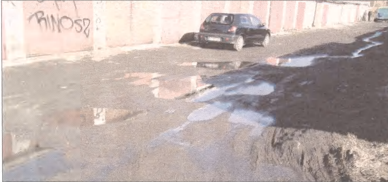
Zdaniem kierowców, na drodze prowadzącej do garaży przy ul. Poniatowskiego jest pełno wyrw w nawierzchni. Administratorzy terenu zapowiadają, że naprawią największe z nich.
