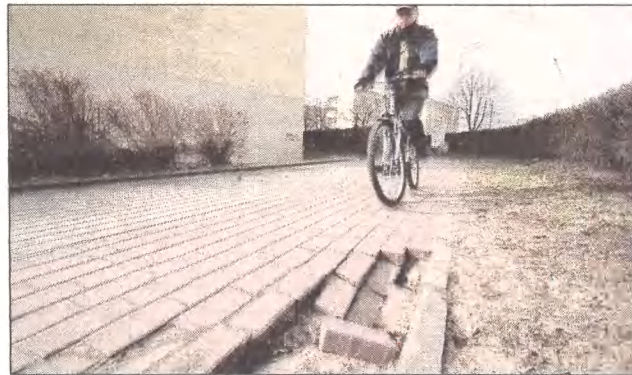
Zapadnięte kostki w ścieżce rowerowej zostaną niebawem naprawione przez drogowców.
