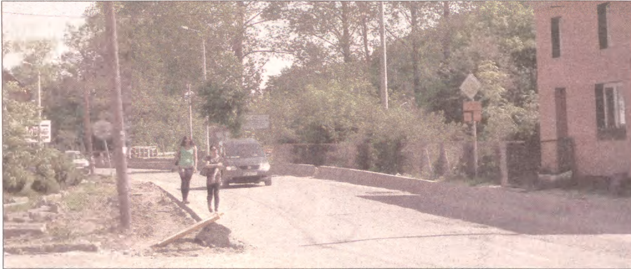
– Wykonawca remontuje drogę i pewnie dlatego zapomniał o bezpieczeństwie pieszych – poskarżyli się nam mieszkańcy.
