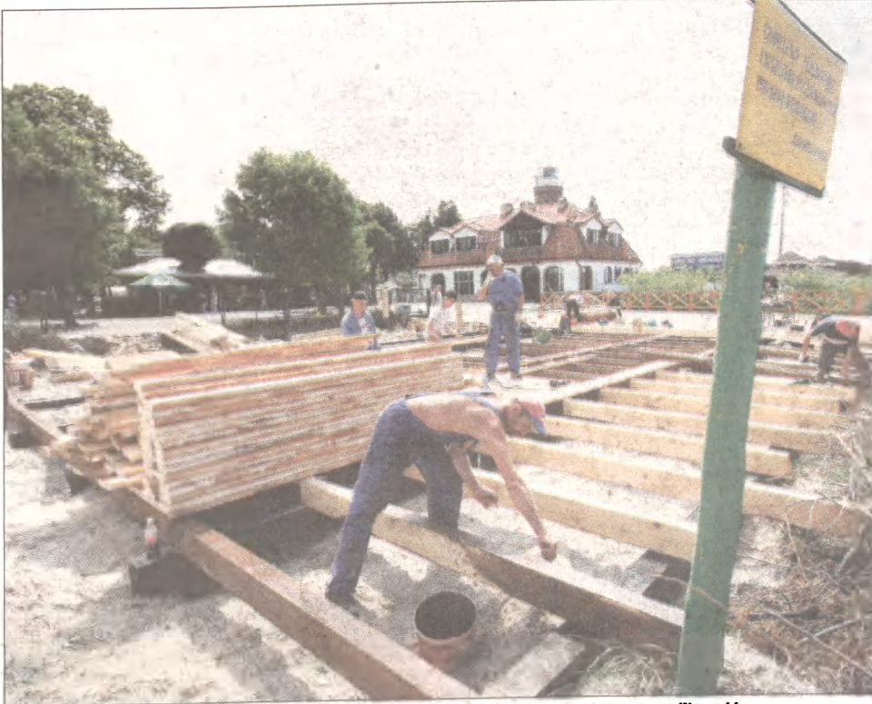
Budowa jednego z obiektów gastronomicznych na wydmy. Podczas prac zniszczono roślinność.
