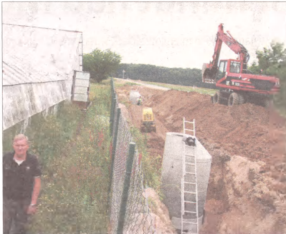
Ojciec Rafała Nowaka zastanawia się, dlaczego wieka studzienek znajdują się na wysokości szczytu ogrodzenia jego posesji.
