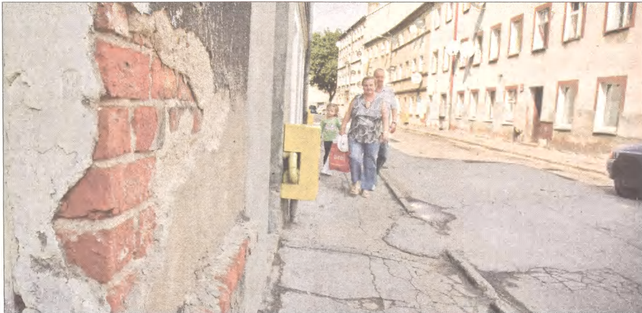
Mieszkańcy ulicy Długiej chcą, by miasto zadbało o nią i przeprowadziło tam niezbędne remonty.
