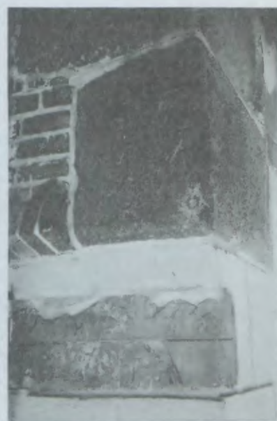
Znaki wysokiej wody na spichrzu „Panna” w Gdańsku Fot. R. Klim
