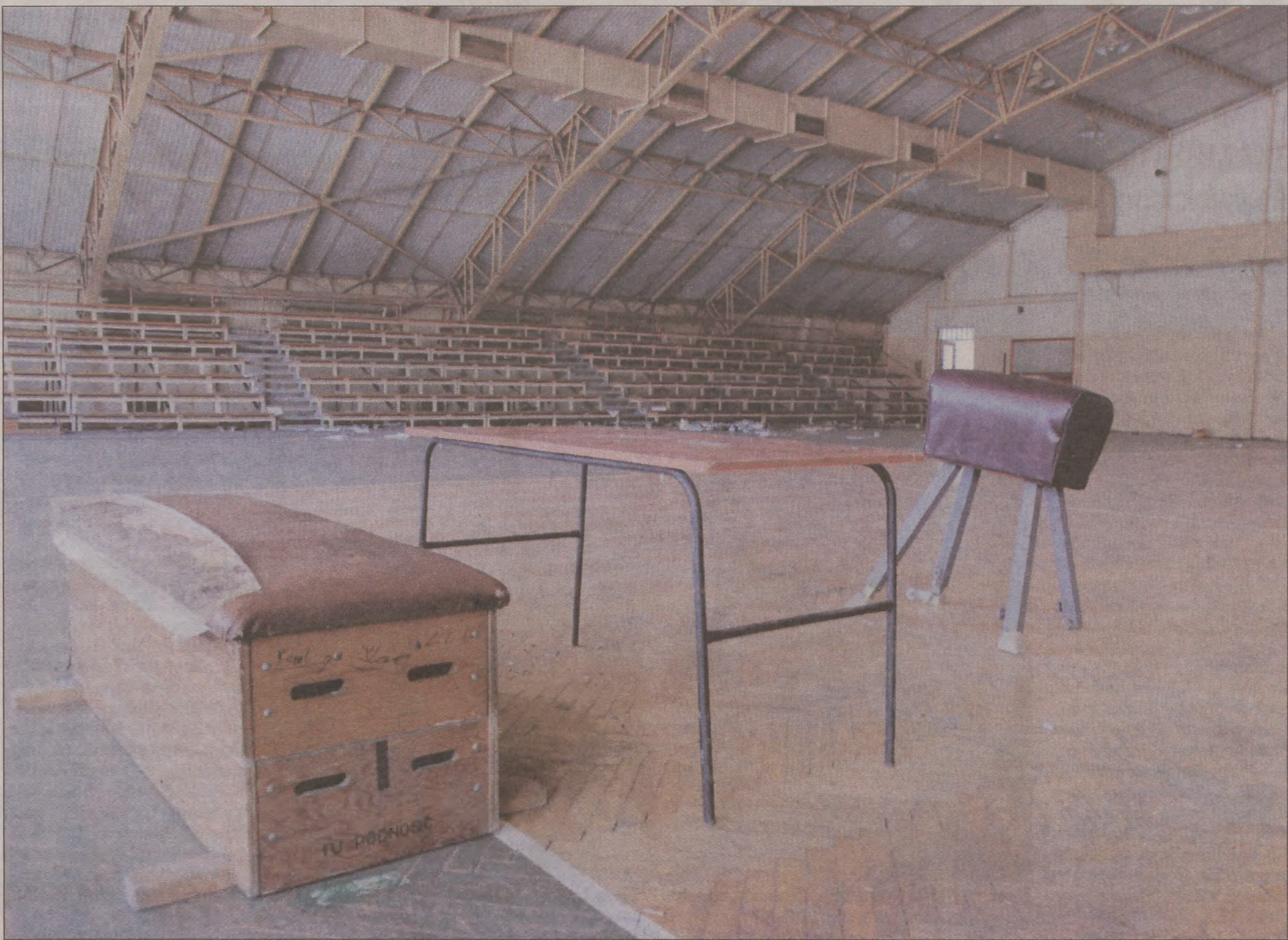
Zdewastowana hala sportowa przy ul. Grottgera w Słupsku. Z powodu fatalnego stanu technicznego miasto chce ją przejąć.
