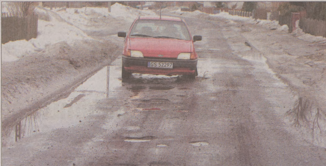
Zdewastowana droga w Karzcinie. Na razie nie jest ujęta w planach remontów ZDM.
