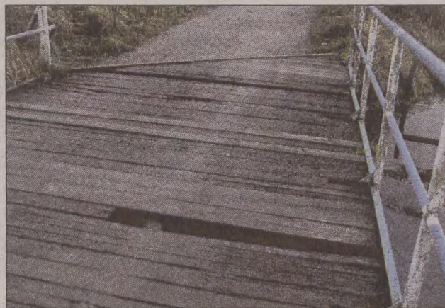
Od kilku miesięcy miasteczki ratusz obiecuje naprawę zniszczonego mostka.
