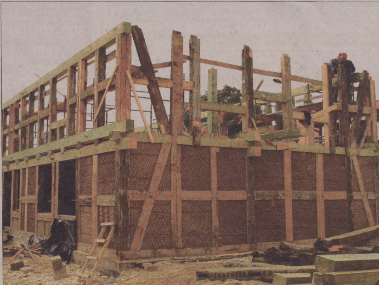
Do tej pory w Ustce rewitalizowano głównie stare budynki. Na zdjęciu: odbudowa domu kapitana Hasse.
