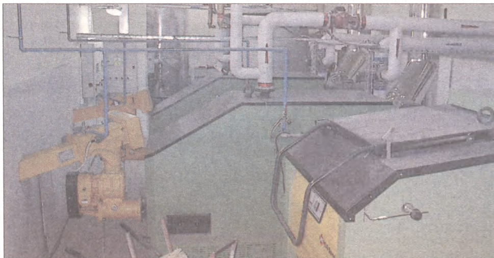
Kotłownia w Biesowicach należy do Zakładu Energetyki Ciepłej w Kępicach.
