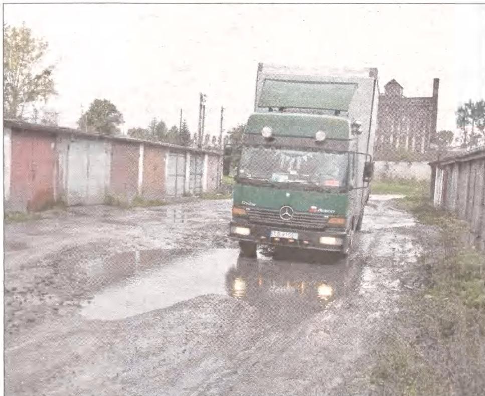
Ciężkie samochody niszczą drogę do garaży. Drogowcy naprawią ją po wyremontowaniu Grunwaldzkiej. Fot. L.C.
