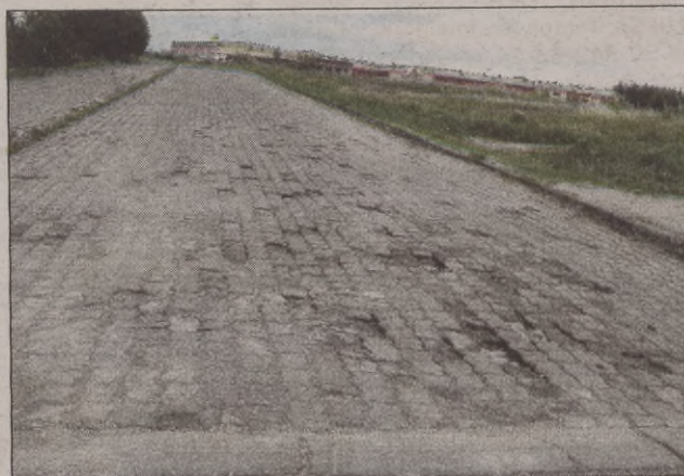
Zniszczona droga dojazdowa do Szkoły Podstawowej nr 2 w Bytowie.
