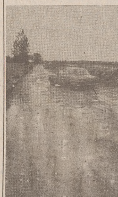
Trwa przebudowa drogi nr 52 Szczecin — Gdańsk. Opodal wsi Piekani- no zbudowany został niewielki objazd. Niestety, na razie nie zapewni on bezpiecznego przejazdu. Wyrwy i doły po opadach deszczu wypełniają się i są pułapkami dla samochodów. Drogowcy powinni bardziej dbać o ten odcinek przewoźniczej jezdni. (kar)
