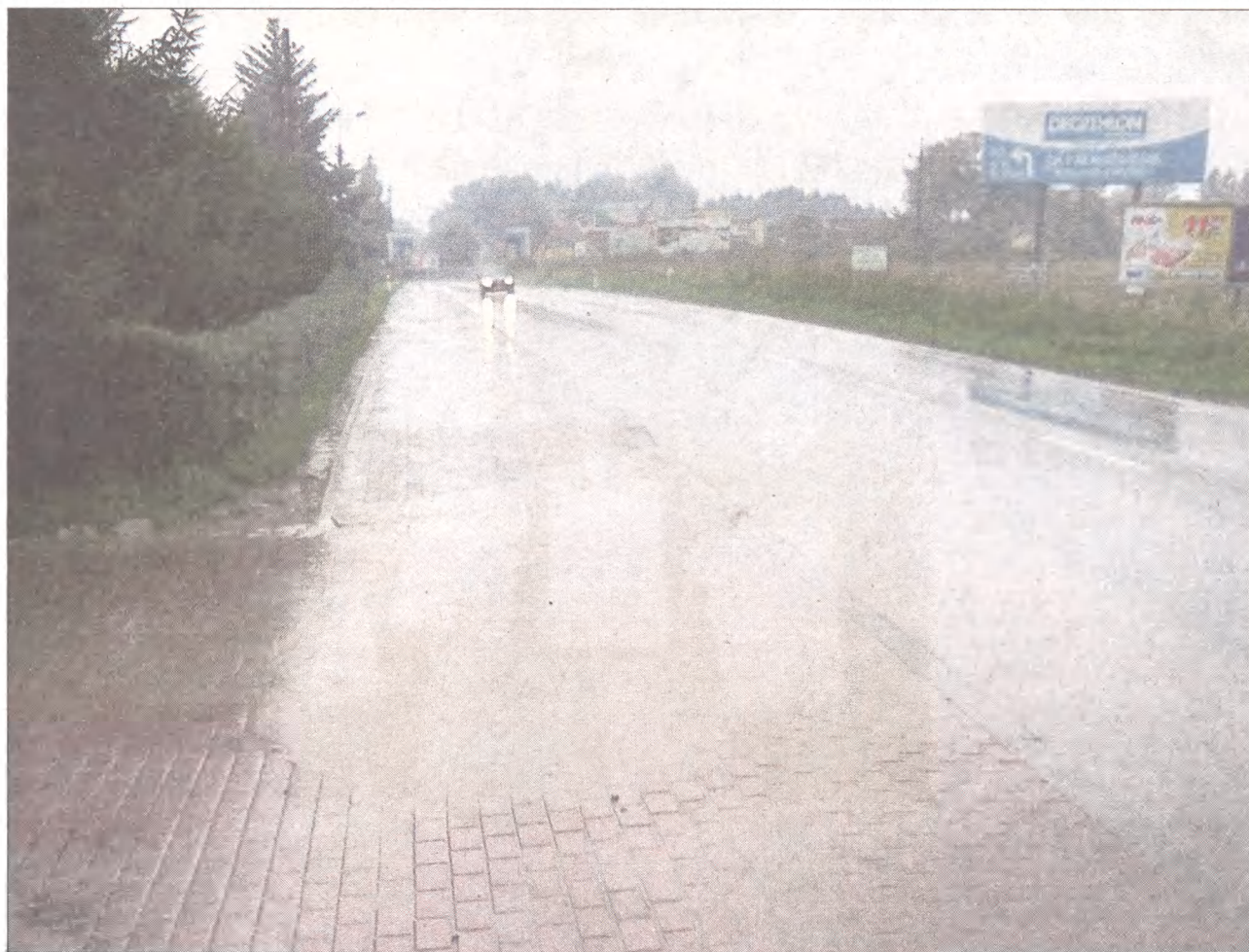
Tak wygląda ulica Bukowa w Kobylnicy po opadach deszczu.
