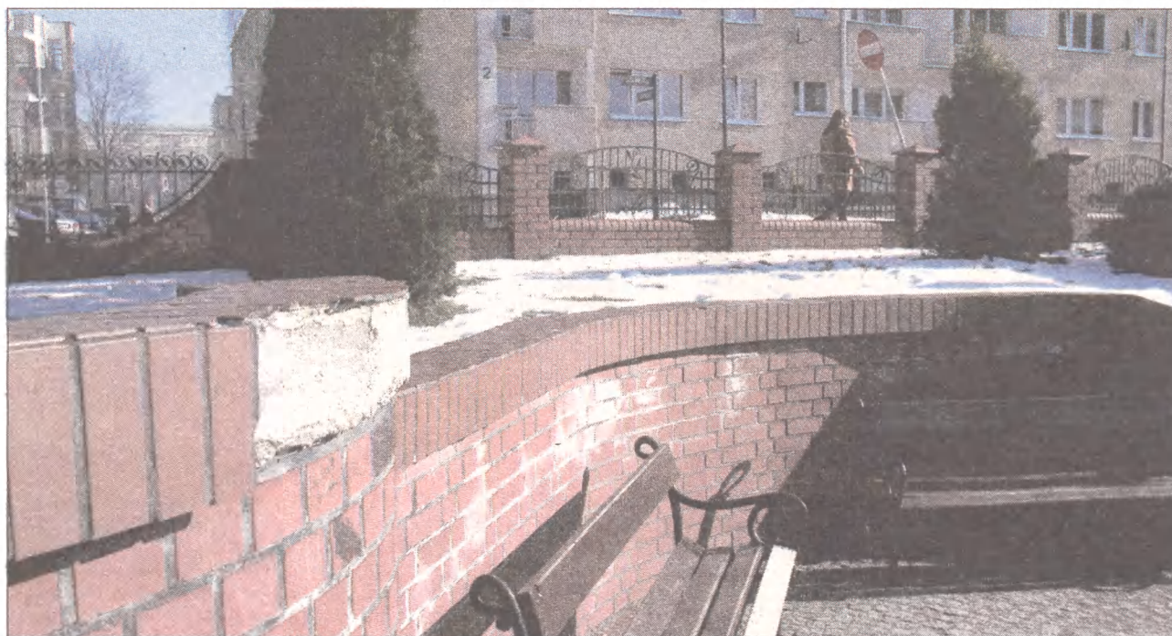
Zniszczony ozdobny murek w parku przy ulicy Bauera w Bytowie.
