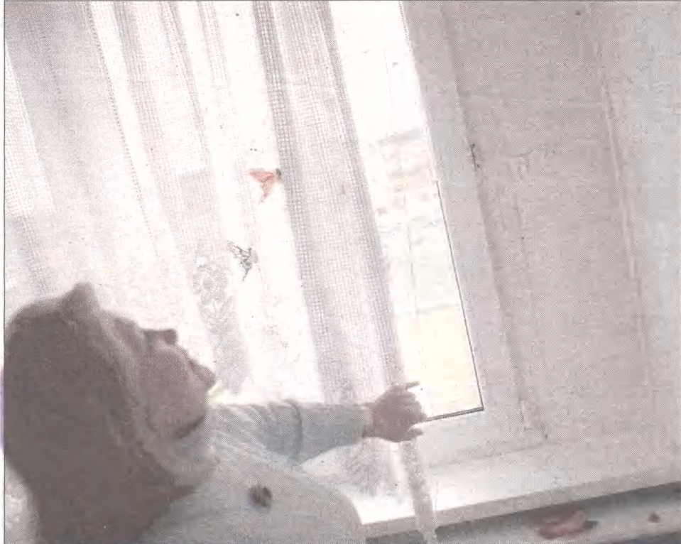
Pani Irena od kilku lat każdej wiosny miała problem z zaciekami na ścianach i w okolicach okien. Po raz pierwszy dostała z tego powodu odszkodowanie od ubezpieczyciela.
