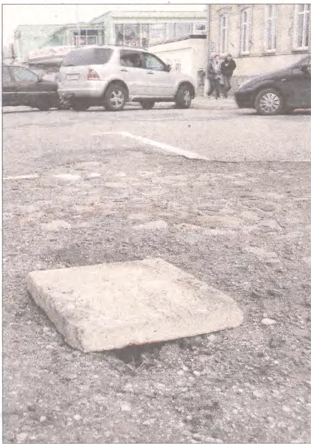
Dziura o kilku metrach głębokości zakryto prowizorycznie płytą chodnikową.
