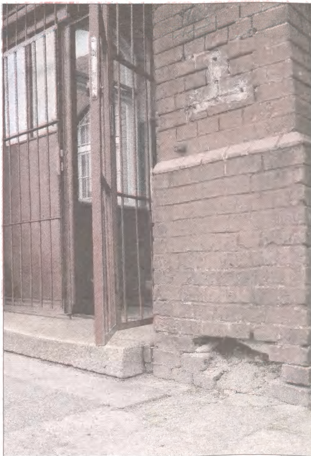
Zniszczona elewacja budynku stacyjnego.
