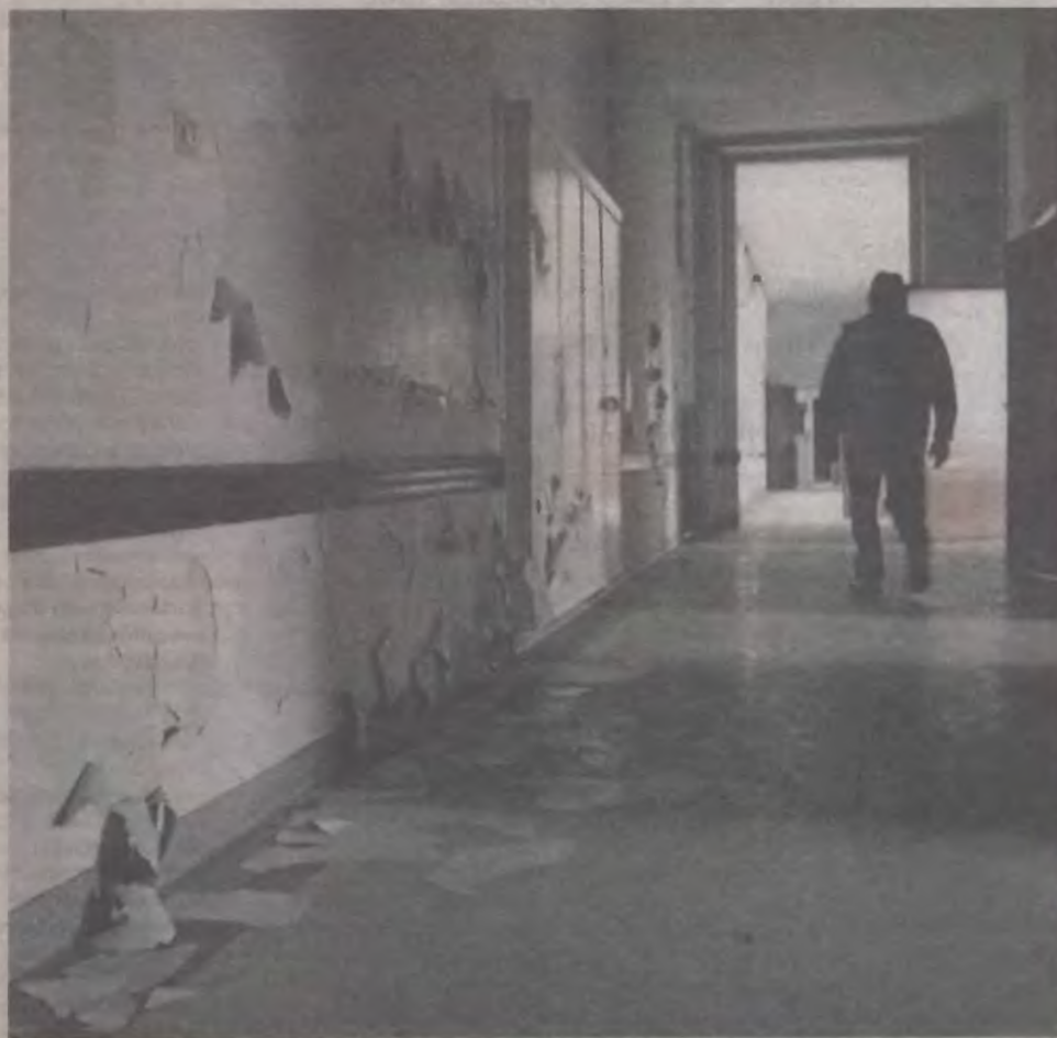
Trzy budynki byłego Państwowego Szpitala Klinicznego nr 3 (zwanego też szpitalem przy Łąkowej czy prof. Kieturakisa (wybitnego lekarza, twórcy gdańskiej szkoły chirurgii) są w coraz gorszym stanie technicznym. Tuż przed wyprowadzką klinik w jego remont zainwestowano kilka milionów złotych
