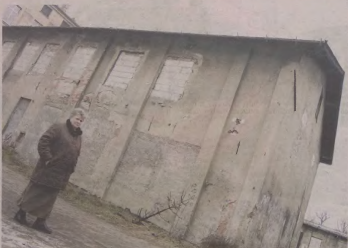
Barbara Klawitter mieszka przy ulicy Dworcowej. Mówi, że okolica dosłownie niszczy w oczach.
