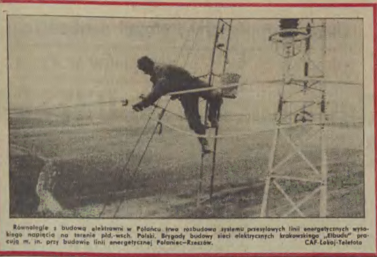
Równoległe z budową elektrowni w Polanicy trwa rozbudowa systemu przesyłowych linii energetycznych wysokiego napięcia na terenie południowo-wschodniej Polski. Brygady budowy sieci elektrycznych krakowskiego „Elbudu” pracują m. in. przy budowie linii energetycznej Polanica-Rzeszów. CAF-Lokaj-Telefoto
