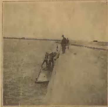
Ryc. 11. Naprawa nadbudówki nabrzeża mola Południowego.
