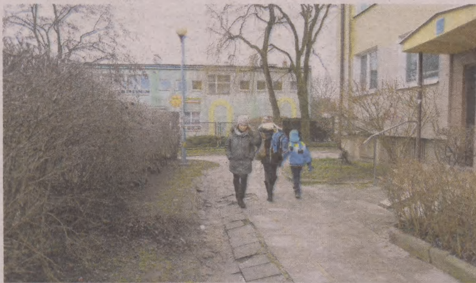
► Chodnik obok bloku przy ul. Wazów 1 jest już bardzo nierówny. Dodatkowo nie świecą się tam latarnie. Mieszkańcy chcą remontu chodnika, ale będą musieli na niego poczekać
