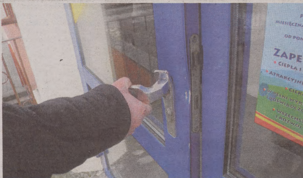
► Drzwi do pomieszczenia, gdzie znajduje się bankomat, zostały zniszczone. Sam bankomat jest uszkodzony, obudowa jest luźna
