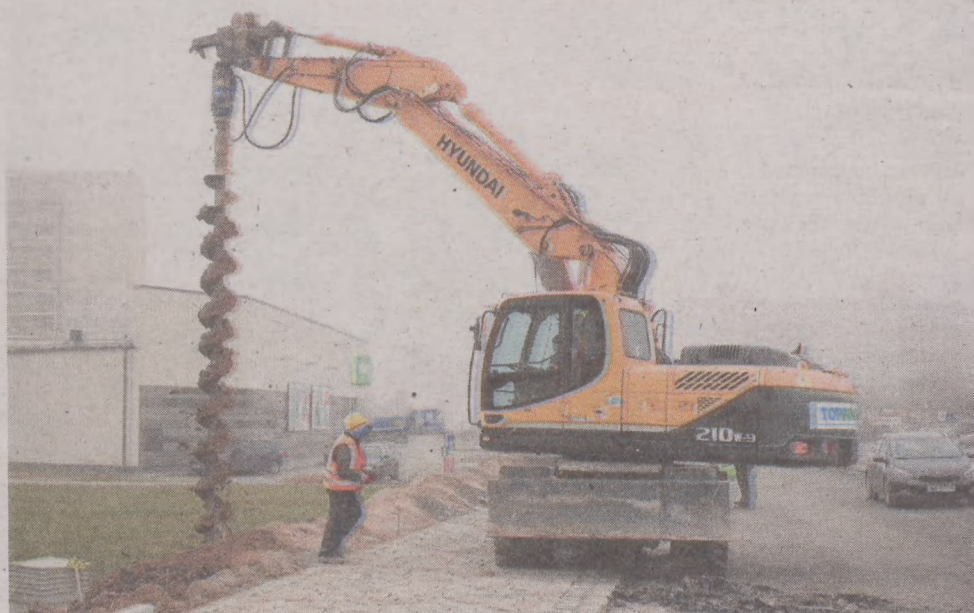
► Przy ul. 11 Listopada trwa przygotowanie do montażu ekranów dźwiękochłonnych. To właśnie podczas tych prac kilka dni temu uszkodzona została rura kanalizacyjna
