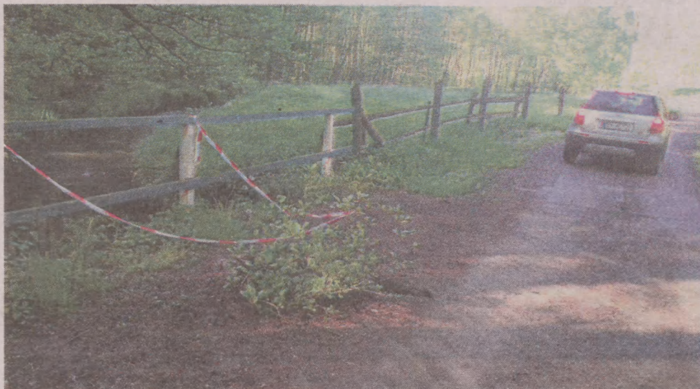
► Zniszczony most między Grzmiącą a Dąbiem. Może będzie wyremontowany na początku wakacji. Rolnicy są zafascynani
