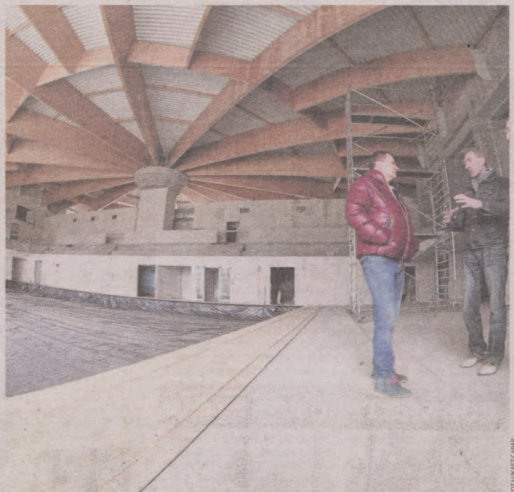
► Słupski akwapark, gdy sprawdzano stan dźwigarów podpierających dach. Ten trzeba rozebrać. Na dokończenie inwestycji trzeba ok. 16 milionów złotych. Nieznane są wszystkie wyroki sądowe
