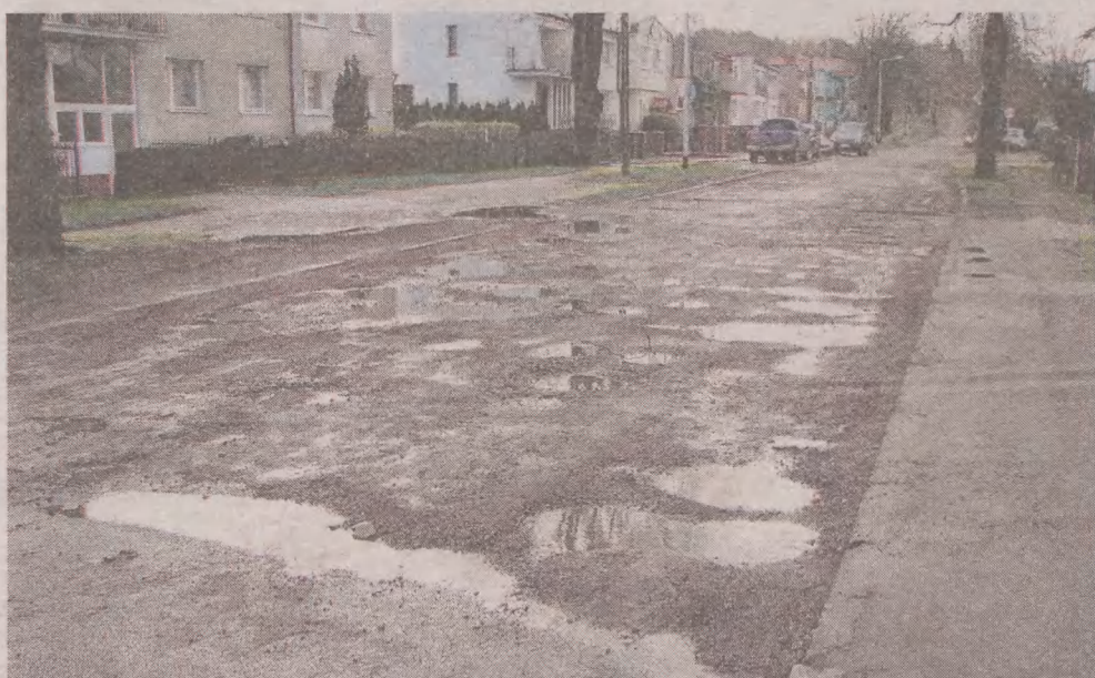
Stan ulicy Sułkowskiego niepokoi tamtejszych mieszkańców. Obecnie jest to droga gruntowa posypana żwirem. Po większych opadach ulica wygląda jak ser szwajcarski
