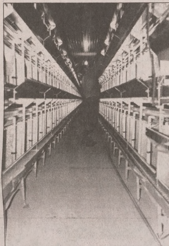
Klatkowa bateria typu Eurovent-Starter zmontowana w Kwakowie.
